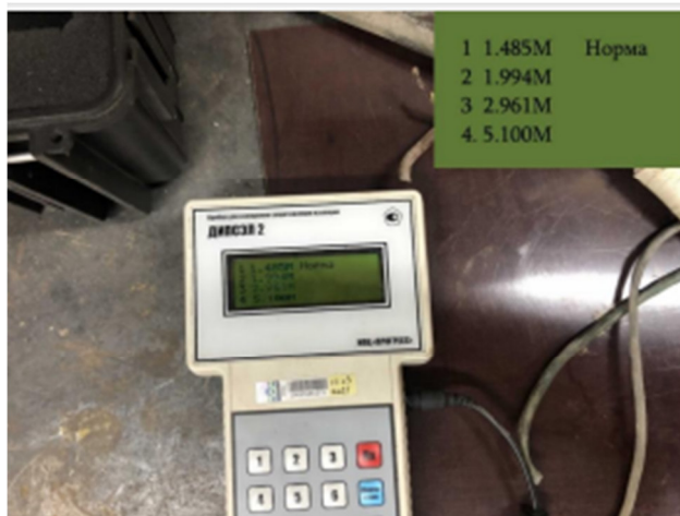
Рис. 4. Результаты замера сопротивления изоляции испытываемого кабеля № 1
