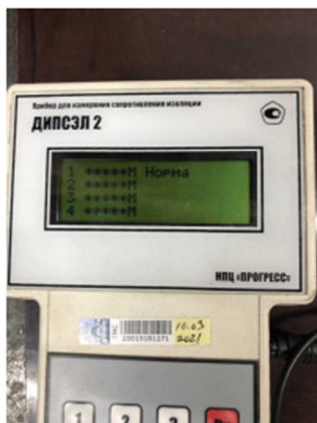
Рис. 5. Результаты замера сопротивления изоляции испытываемого кабеля № 2
