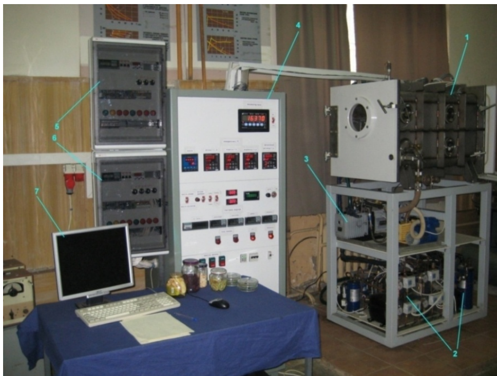
Общий вид лабораторного комплекса СВП-0,36 для изучения процессов вакуумного обезвоживания: 1 – вакуумная камера; 2 – холодильная станция – 2 шт.; 3 – вакуумная станция; 4 – пульт управления; 5 – пульт управления среднетемпературной холодильной машиной; 6 – пульт управления низкотемпературной холодильной машиной; 7 – персональный компьютер оператора
