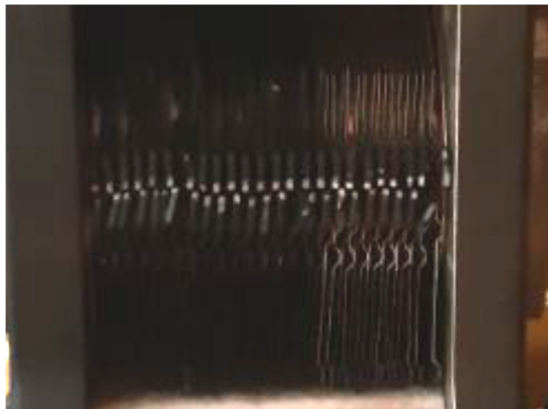
Рис. 7. Повреждение пластин теплообменника «Петр Саблин» (август 2016 г.)
