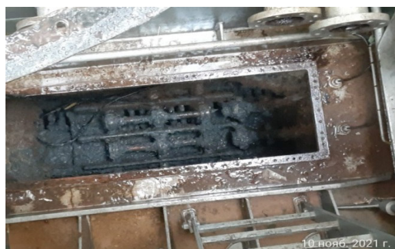
Рис. 12. Состояние кингстонных ящиков после демонтажа боксулеров на «Мангыстау-5» (2021 г.)
