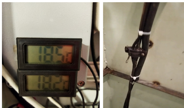
Рис. 2. Общий вид установленного термометра HT-1 black и измерительного кабеля с датчиками в малом опытовом бассейне
